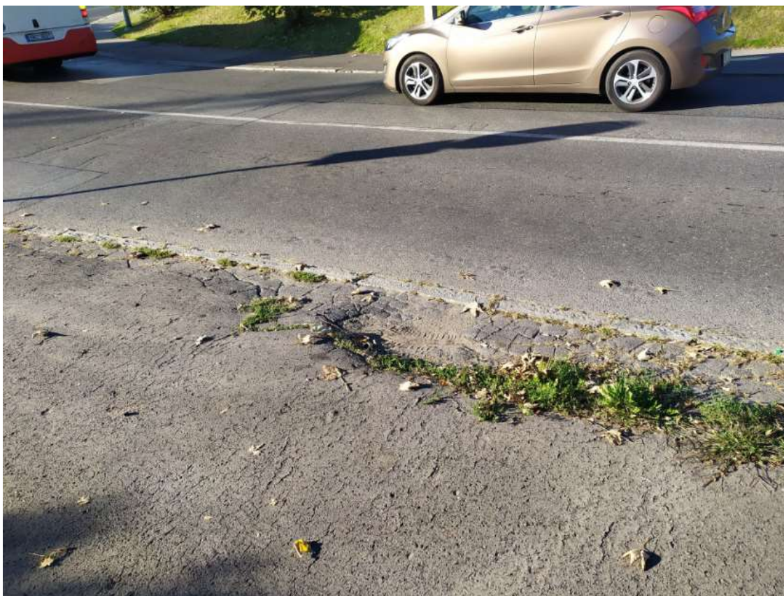
Obrázek 5 – Poruchy vozovky v ulici Na Vypichu, zdroj [1]
