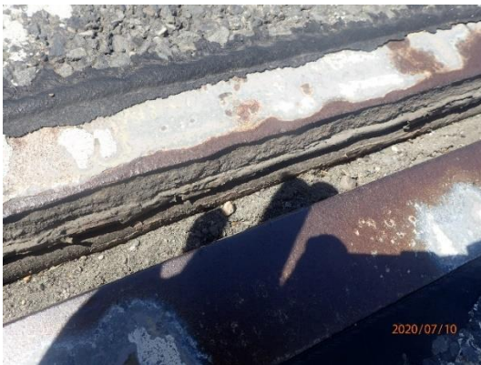
Obr. 10 Zkorodování mostních závěrů (foto: Tomáš Dejmek)
