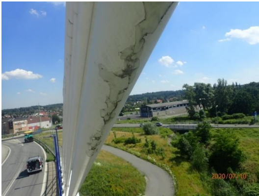
Obr. 8 Poškození protikorozi ochrany na dolním líci závěsů (foto: Tomáš Dejmek)
