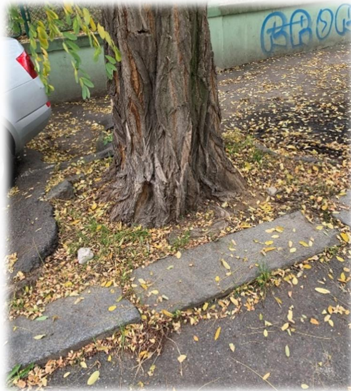
Obr. 21: Poškození chodníku vlivem kořenů (54)
