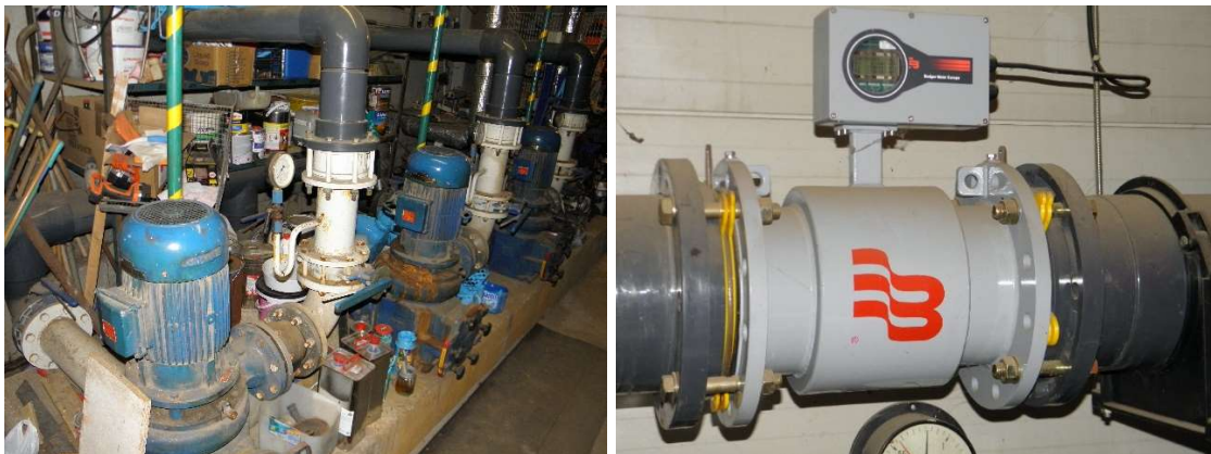
cirkulační čerpadla a magnetoindukční průtokoměr
