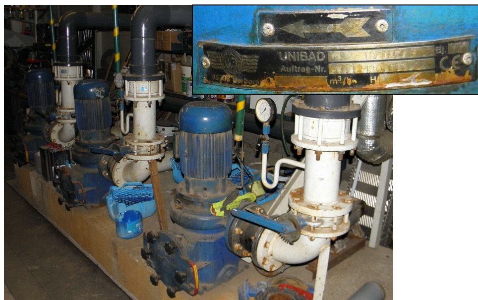
Obrázek 21. Stávající cirkulační čerpadla + štítek
