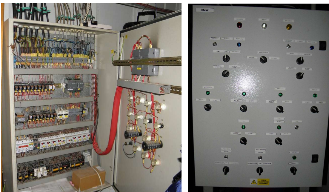
elektrický rozvaděč a ovládací panel
