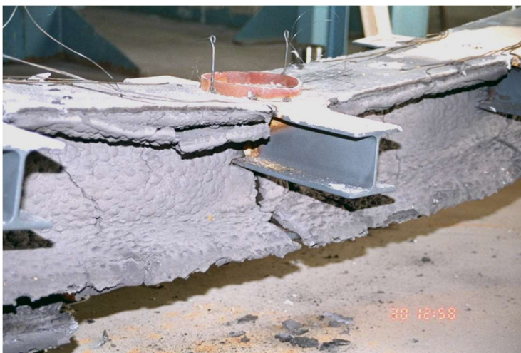
obr. 21 Trhlina ochranné vrstvy[18]
