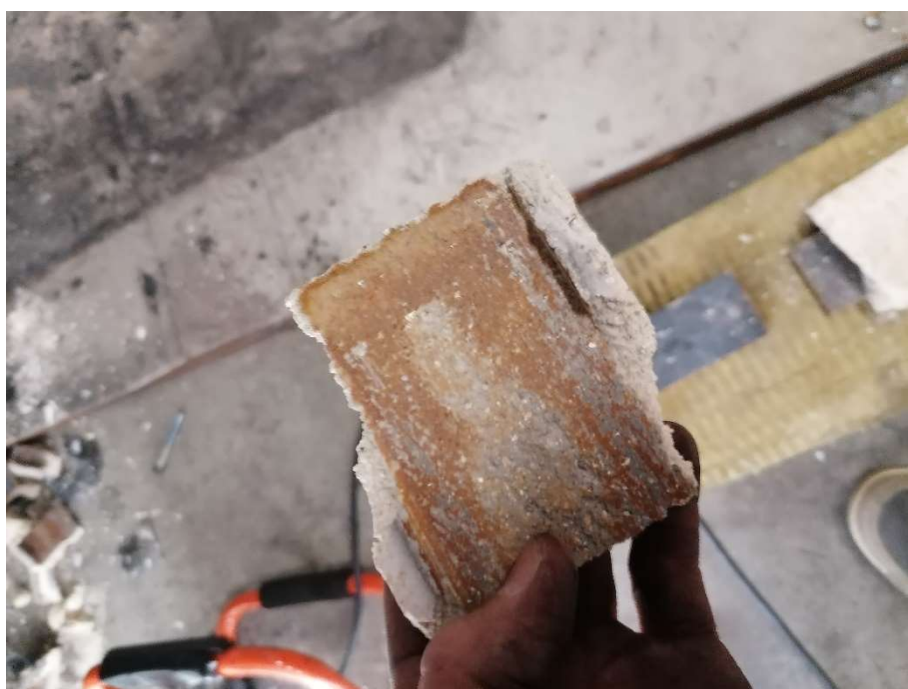
Obr. 60 Odpadlá část požární ochrany
