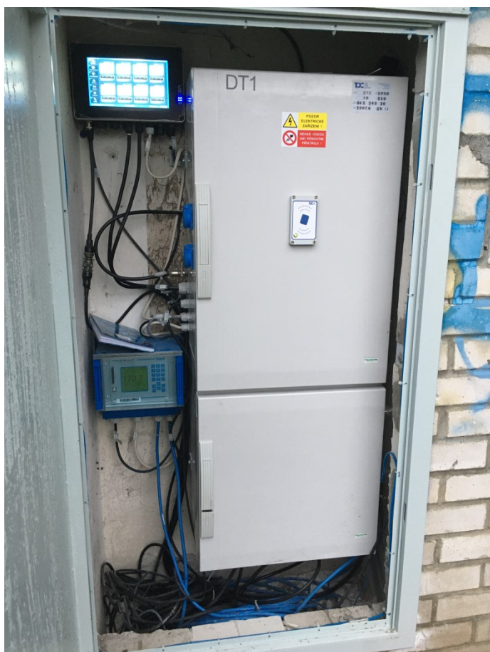
Obrázek 4.4- Řídicí jednotka měrné stanice na profilu D1-PAPÍRENSKÁ-Q
