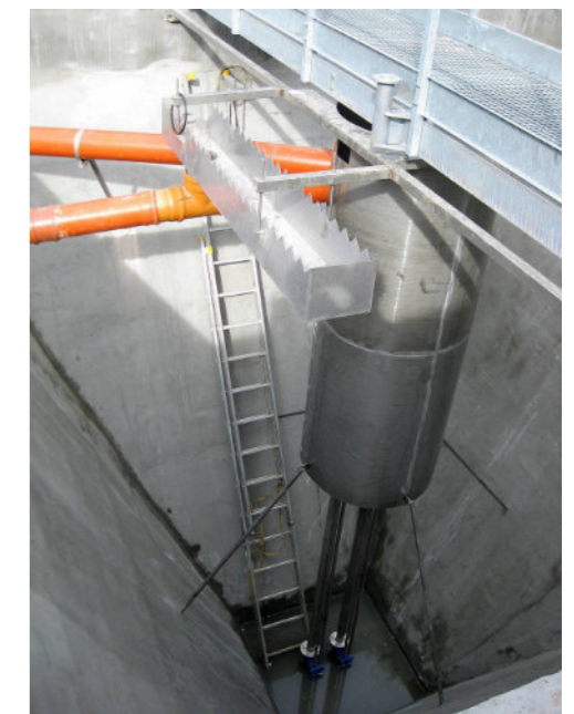
Obr.11: Nové zařízení instalované při modernizaci ČOV
