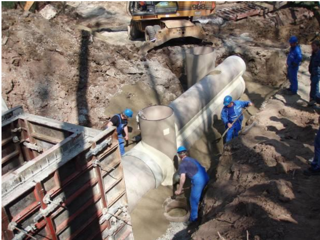
Obrázek 23 - Instalace CSO v Moravském Krumlově (13)
