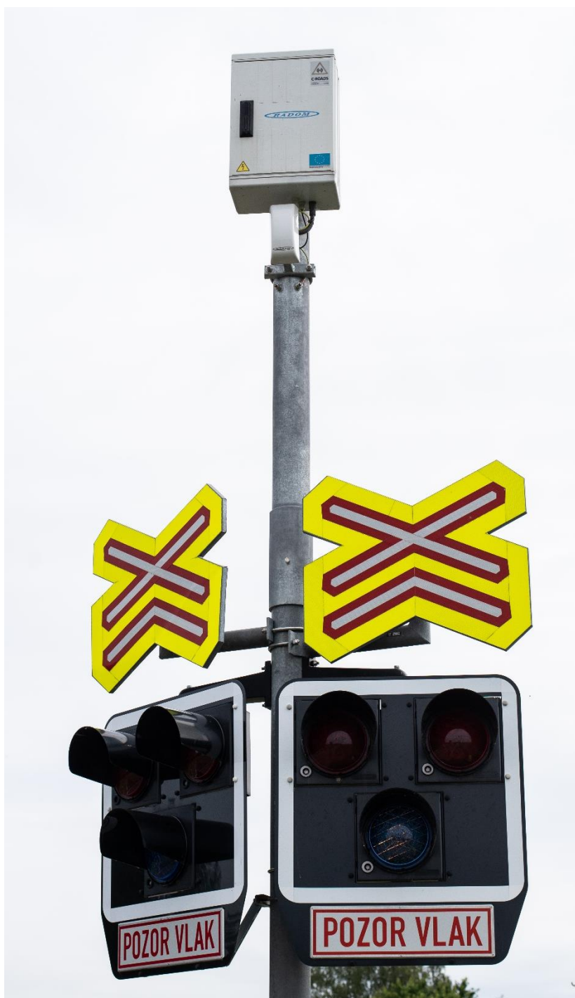
Obrázek 18: Přejezd P5013 s instalovaným C-ITS zařízením
