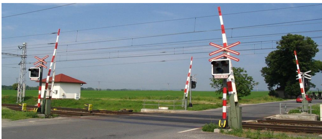
Obrázek 12: Přejezd zabezpečený přejezdovým zabezpečovacím zařízením [34]
