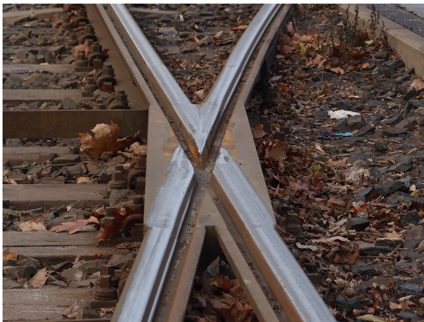
Obr. 7. Původní „hluboká“ srdcovka výhybky 567. Na snímku je rovněž jasně patrné opotřebení jejího hrotu (12/2016, archiv J. Hradila).
