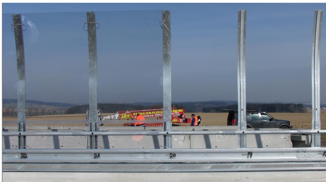
Obr. 24 Experimentální záchytný systém čelní pohled
