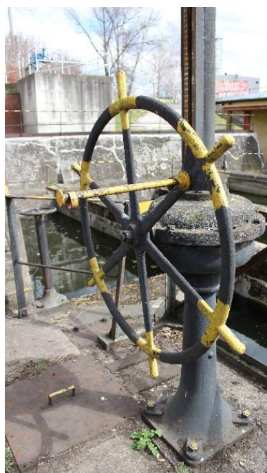
Obrázek 61 Detail původního zařízení 254
