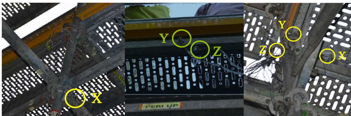
Obrázek 59: Ukázka snímačů instalovaných na konstrukci – pozice č. 2 (vlevo a uprostřed) a krajní pozice č. 3 (vpravo) [7]
