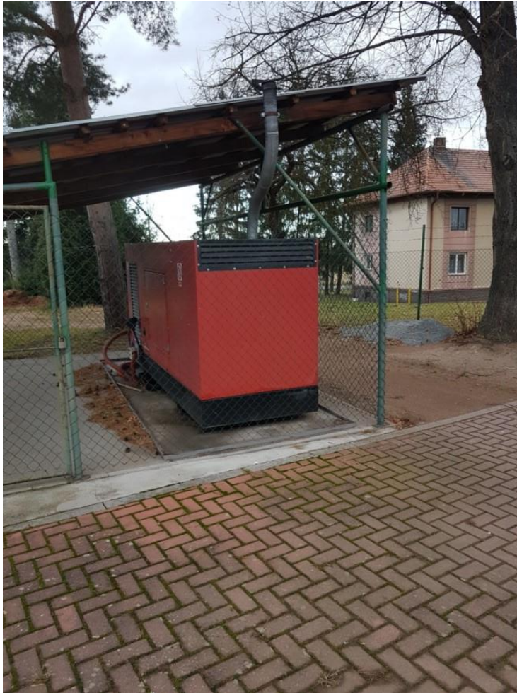
Obrázek 5 Dieselagregát Magnum 150 VSA v Centru Zbůch (zdroj vlastní)
