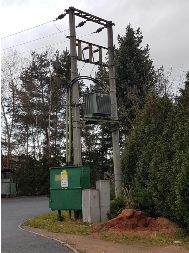
Obrázek 4 Distribuční trafostanice PS 0808 (zdroj vlastní)
