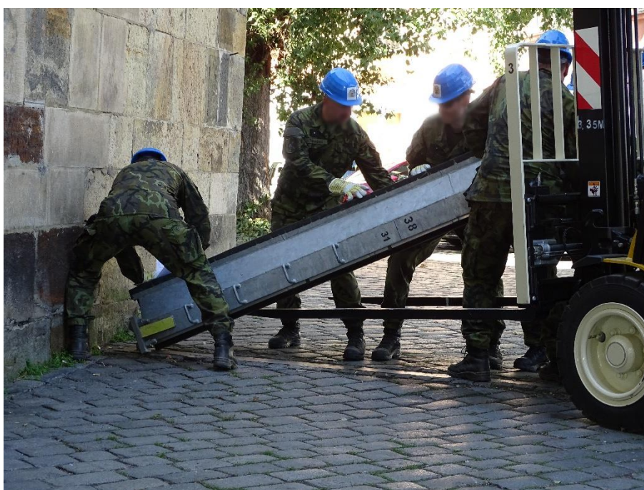
Příslušníci aktivních záloh AČR při instalaci slupice přiléhající ke Karlovu mostu (zdroj: vlastní)
