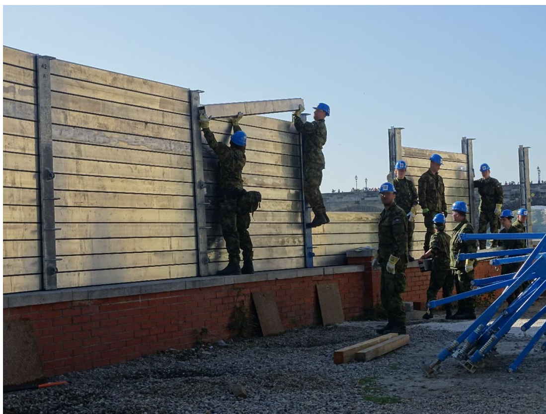
Příslušníci akčních záloh při instalaci PPO – dokončování instalace protipovodňové stěny (zdroj: vlastní)
