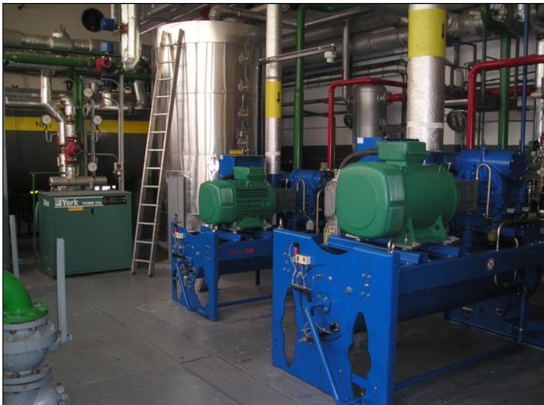
Obrázek 3 Strojovna chladicího zařízení. Zdroj: HZS MSK
