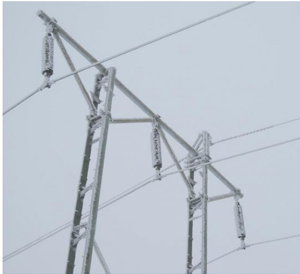
Obrázek 12 Námraza na stožáru typu „SEDLÁK“ venkovního vedení 1 x 110 kV. [57]
