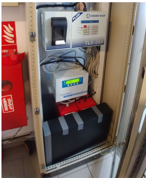
Obrázek 24 - UPS zdroj – foto vlastní
