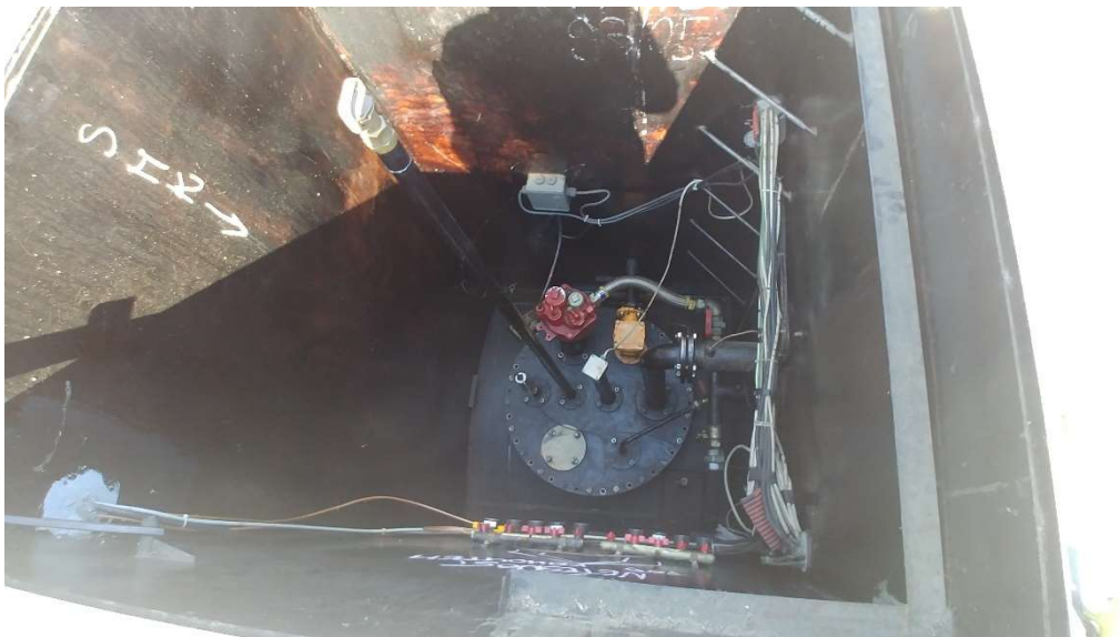
Obrázek 19 - Obslužná šachta k tankové nádrži – foto vlastní
