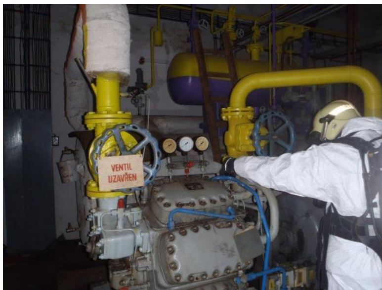
Obrázek 4 Strojovna zimního stadionu Hořovice [11]
