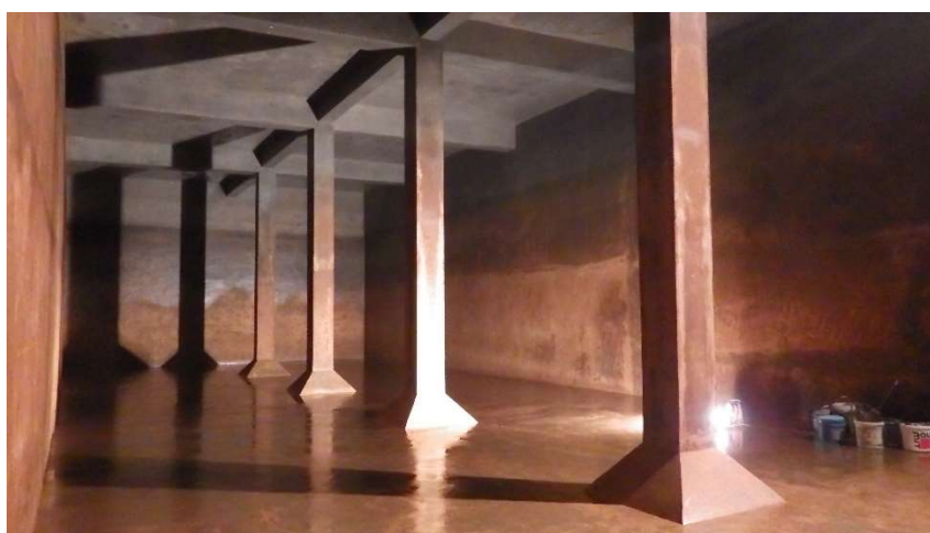
Obrázek 19 Pohled do akumulční komory VDJ Brno Lesná
