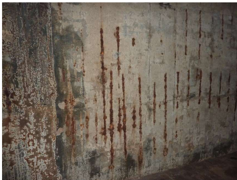
Obrázek 13 Koroze výztuže stěny akumulční nádrže
