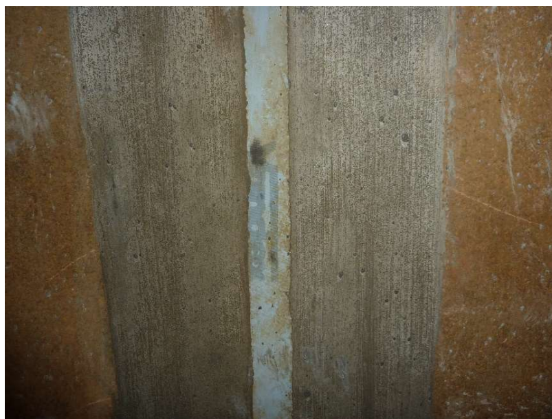
Obrázek 12 Dilatace stěny akumulční nádrže
