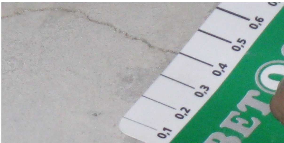
Obrázek 79 – detail trhliny z Obr. 73 Plaza Plzeň, 2010
