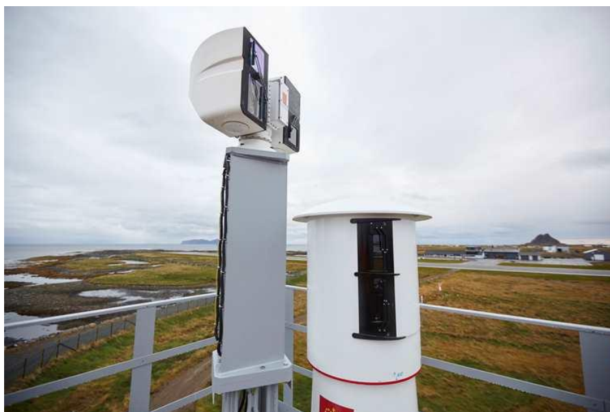
Obrázek č. 13 - infračervené kamery a technologie k detekci pohybujících se objektů – vzdálený věžový systém KONGSBERG. Zdroj: [38]
