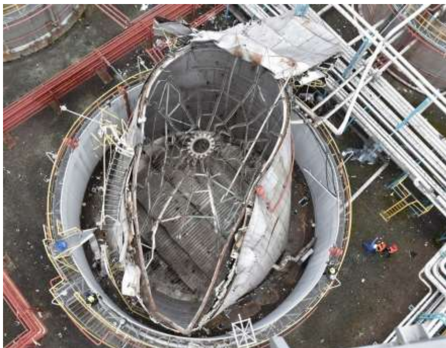
Obrázek 17 – Pohled na výbuchem zničenou nádrž [29]
