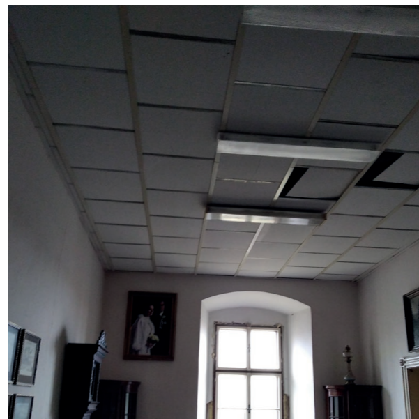
Umakartové podhledy zavěšené do železných traverz
