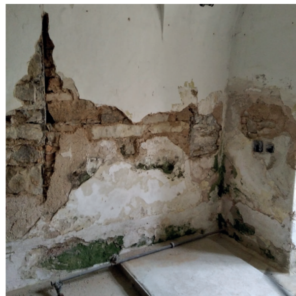
Vlivem vlhkosti roste na stěnách v přízemí mech
