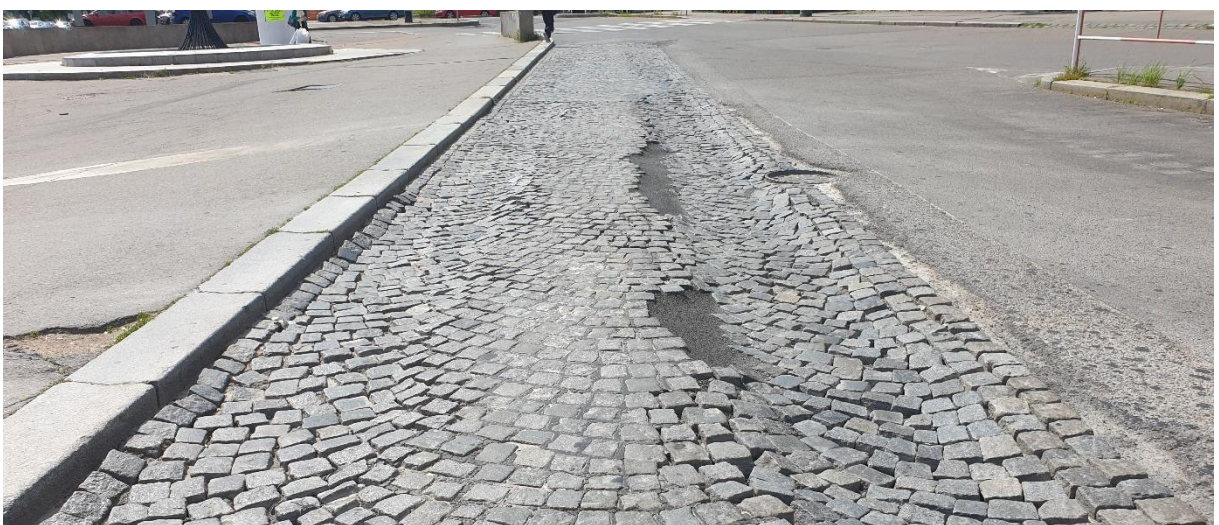
Obrázek 27: Vyjeté koleje a porušená vozovka na výstupní zastávce G
