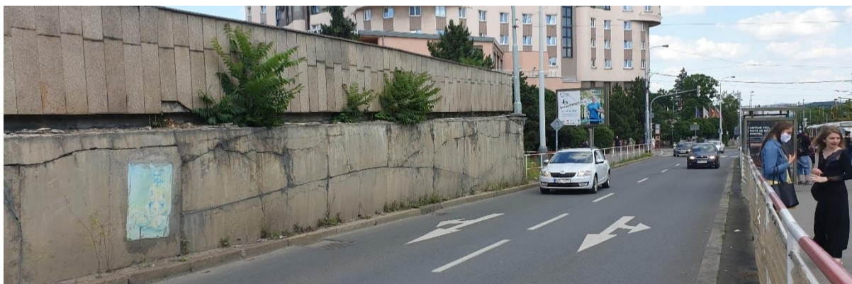
Obrázek 29: Špatný stav opěrné zdi
