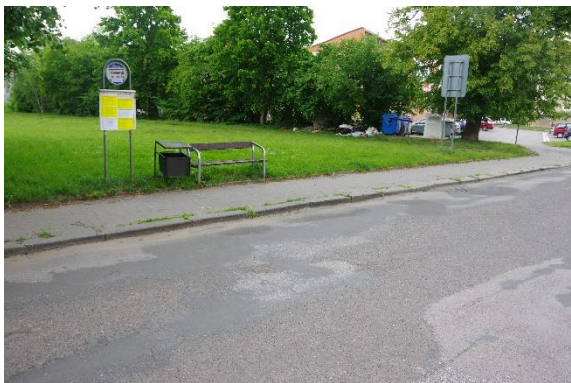
Obr. 45: Úsek č. 42 - Chybějící VDZ 65
