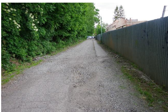
Obr. 43: Úsek č. 36 - Nevyhovující povrch komunikace 63
