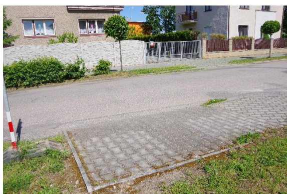
Obr. 13: Úsek č. 12 - chybně vytvořené místo pro přecházení 34
