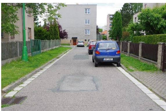
Obr. 38: Úsek č. 22 - Nedostatečný průjezdný profil 58
