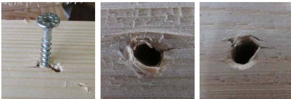
Obr. 37: Porušení dřevěných lamel v místě vrutů
