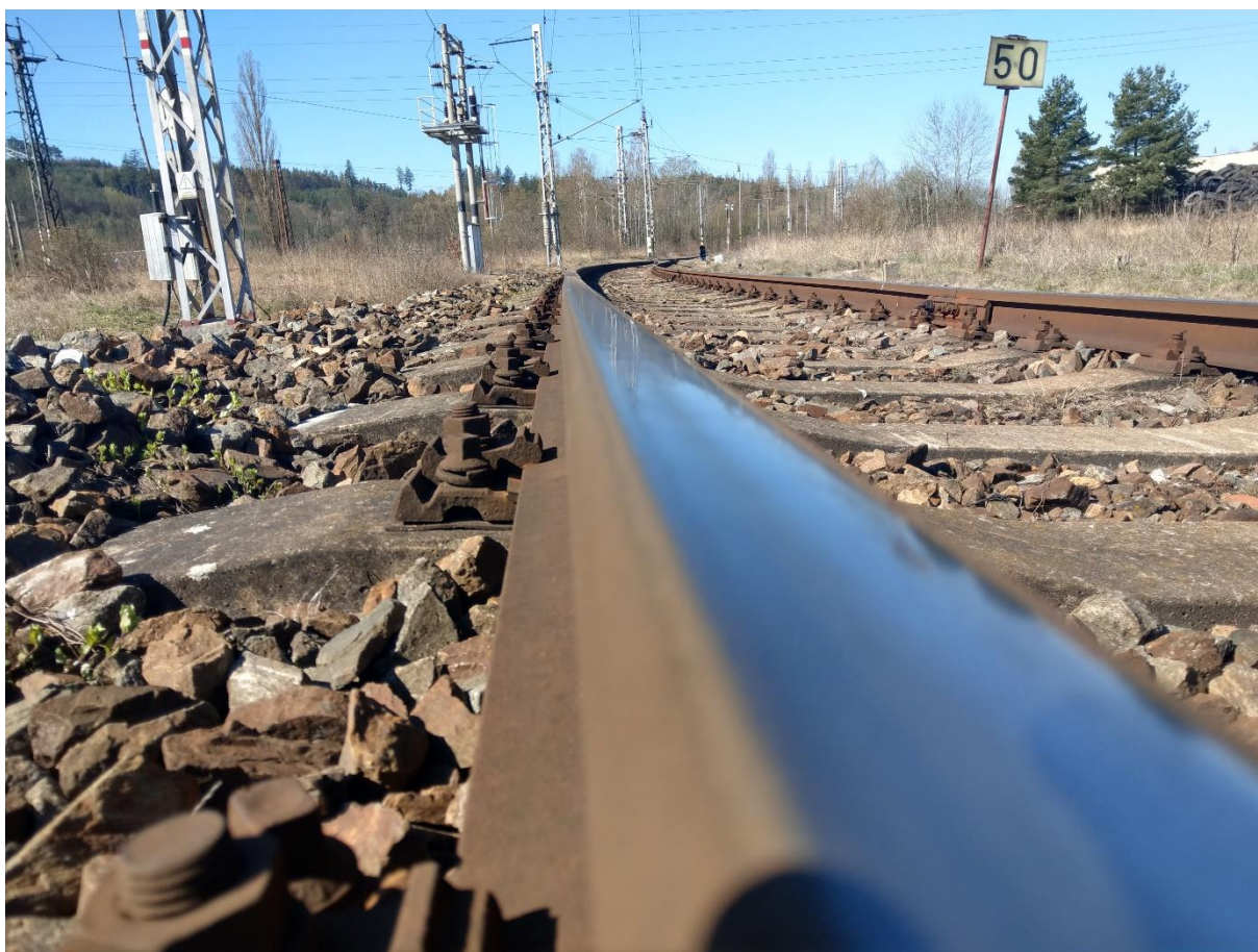
Obrázek 35: Nedostatečné převýšení u stanice Ražice, Autor: Vlastní tvorba
