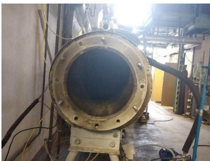
Obrázek 11: Čelní pohled do prostoru sušárny s vyjmutým míchadlem
