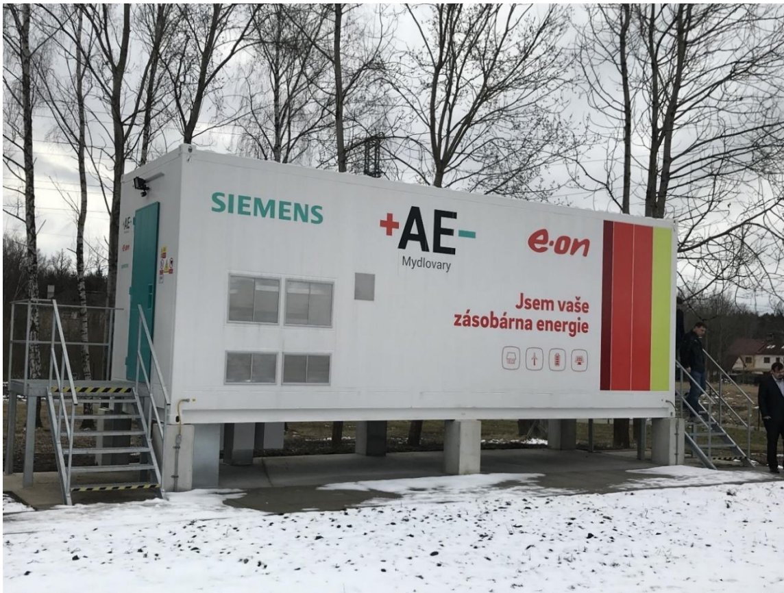
Příloha 1: Bateriové úložiště společnosti E.ON Česká republika, s.r.o., v Mydlovarech [25]
