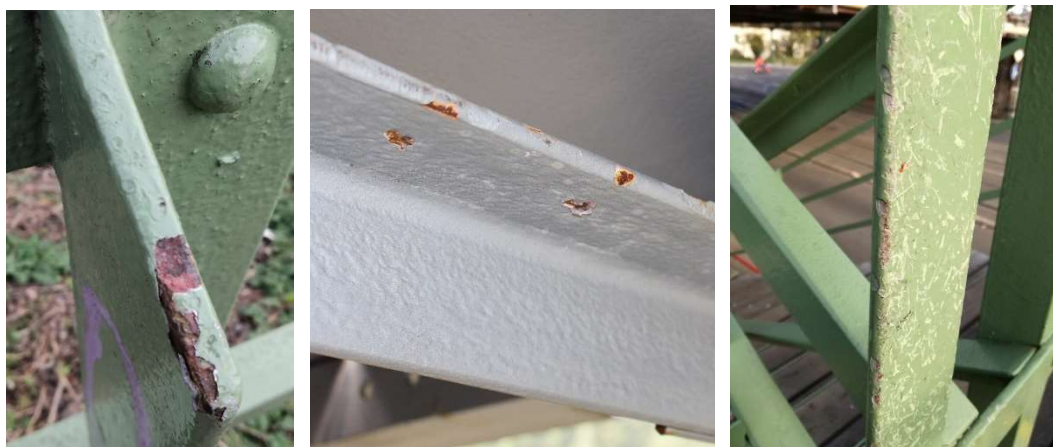
Obrázek 49 - Mechanické poškození nátěru
