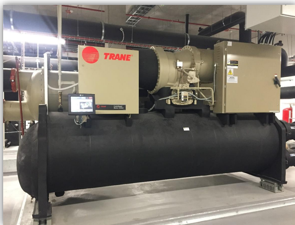
Obr. 22 Chladicí jednotka TRANE CVGF800
