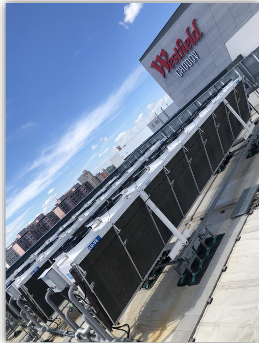
Obr. 13 Suché chladiče (střeša OC Chodov)
