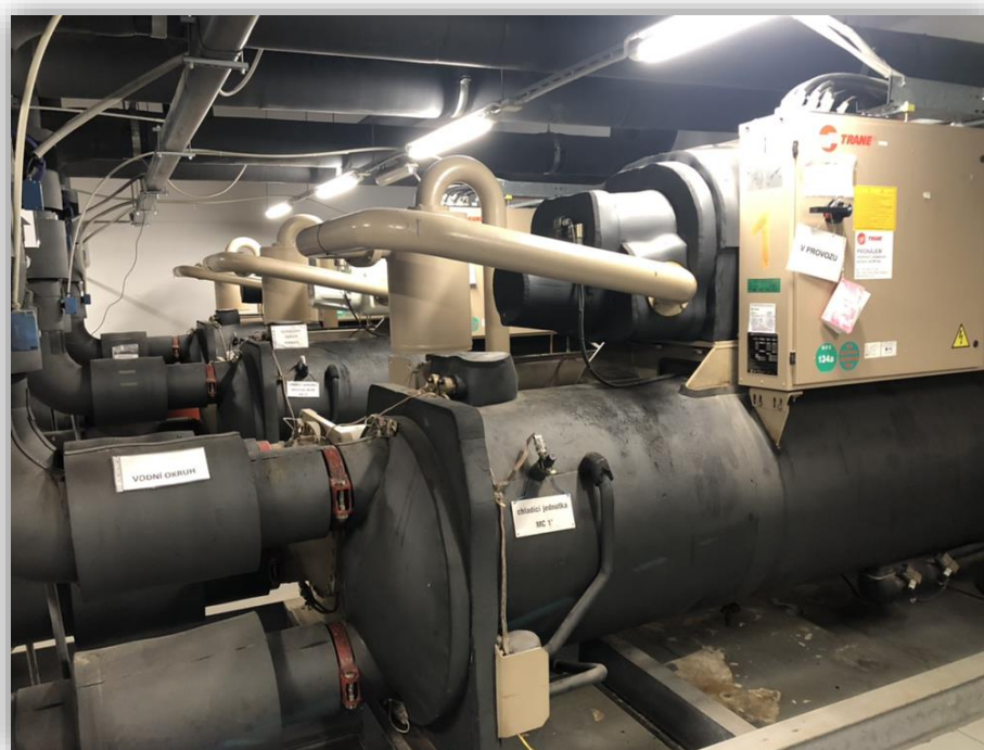
Obr. 20 Chladicí jednotky Trane (východ)
