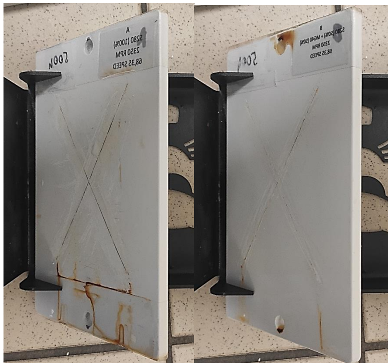
Příloha 15 Koroze na hranách – S280 vzorek 6 (vlevo), S230/MG40 vzorek 7 (vpravo).
