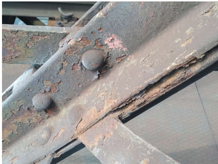
Obrázek 2 - Typický detail – neprůchozí štěrbina v diagonále s těžkým přístupem (Vyšehradský most) [8]
