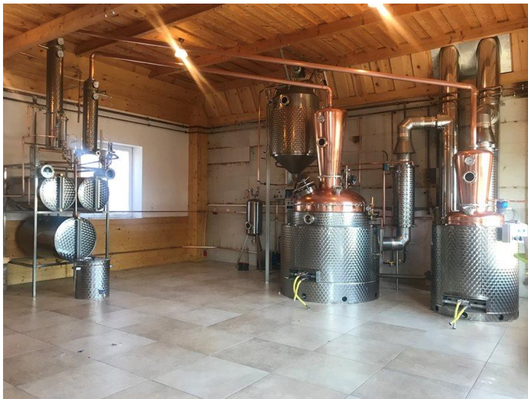
Obrázek č. 12 Dvoukotlová kolona vytápěná plynem, Sajókaza (HU), výrobce Kovoděl Janča, s. r. o. [33]
