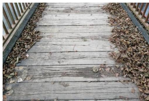
Obr. 13: Dřevěná mostovka – ztrouchnivělá
