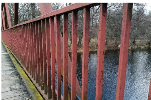
Obr. 12: Zanedbaná antikoroziční ochrana
