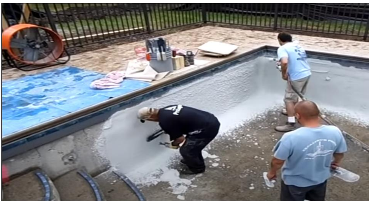
Obrázek č.25 – Aplikace bílé omítky v bazénu, osoba vpravo aplikuje vrstvu omítky stříkací technikou a osoba vlevo stěrkou uhlazuje povrch nastříkané vrstvy
