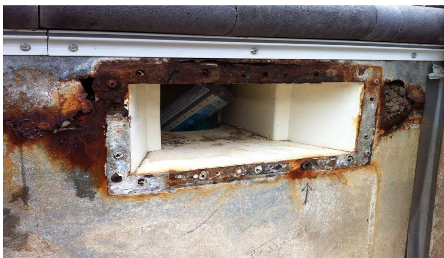
Obrázek č.36 – Důsledek působení slané vody na skimmer; Foto Swimmingpoolsteve
