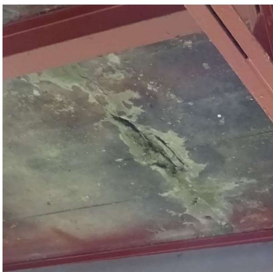
Obr. 14 Detail obnažené výztuže desky
