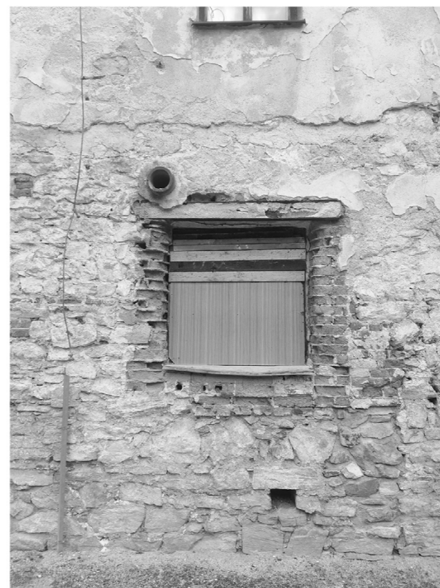
Degradující zdivo a otvory
