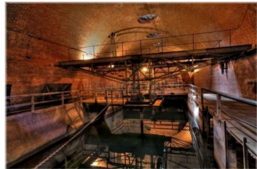
Obr. 2: ČOV Praha-Bubeneč pohled z interiéru [34]
