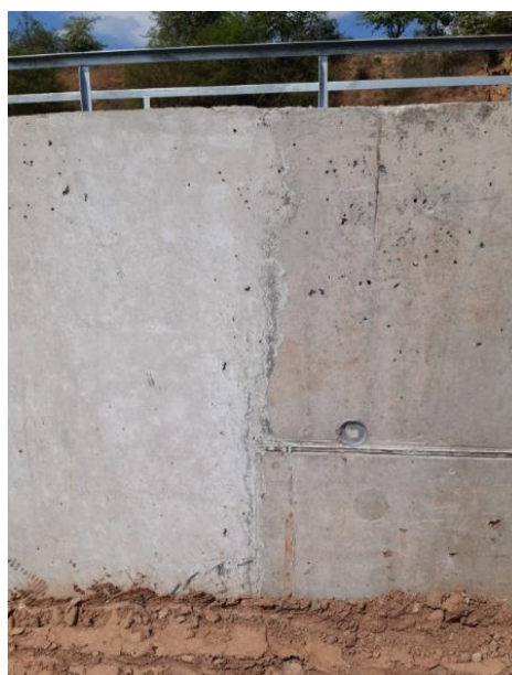
Obr. 50: Pracovní spára na stavbě
