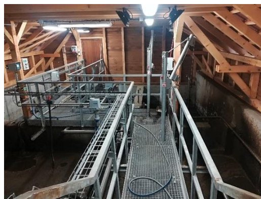
Obr. 11: ČOV v Malečově – pohled zevnitř
