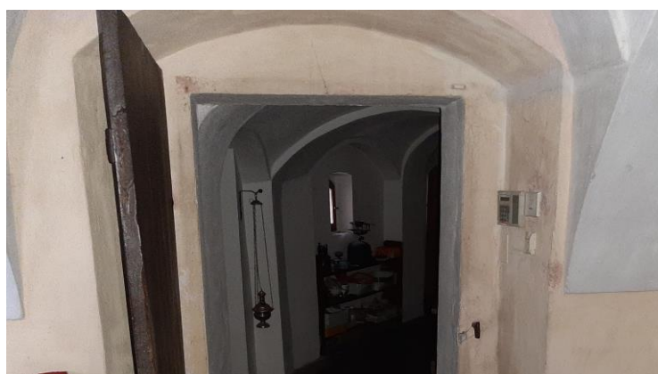
Obr. 105 Foto T.2.2. - nadpraží kostel
