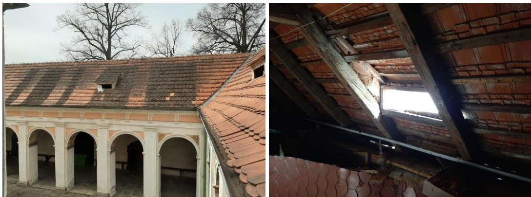
Obr. 58 Zastřešní ambitů a Obr. 59 střešní vikýř
