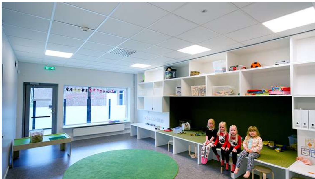
Obrázek 20: Vzduchotechnika od Lindabu díky difuzorům Versio NS19 a plenum boxům MBB skrytým ve stropě zajišťuje, že vzduch je rozptýlený a že se šíří komfortním způsobem. [23]
