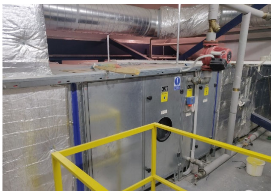
Obr. 1.22: Sestavná VZT jednotka v první sekci, zásobující polovinu hlavního sálu [autorská tvorba]
