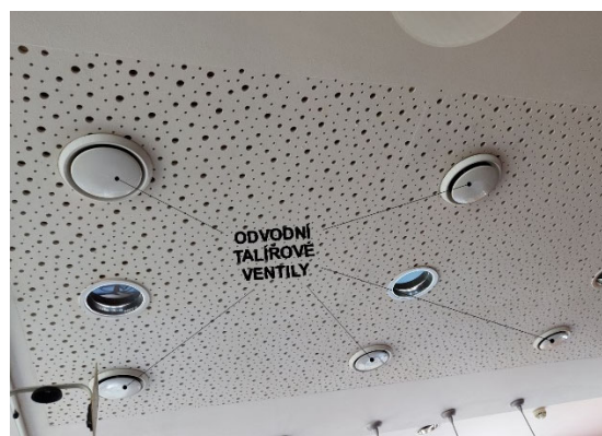
Obr. 1.25: Odvodní talířové ventily v místě nad barem [autorská tvorba]
