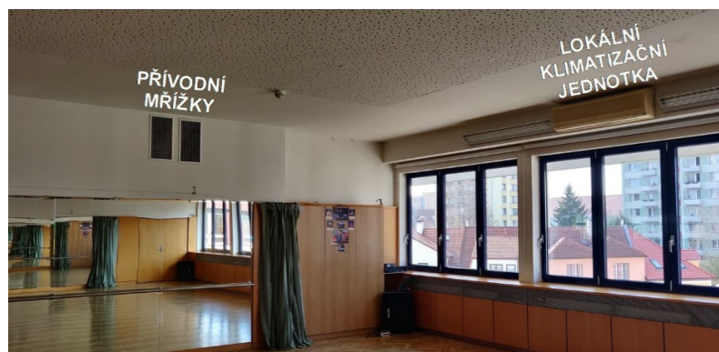
Obr. 1.27: Přívodní větrací mřížky a lokální klimatizační jednotka v malém gymnastickém sálu [autorská tvorba]
