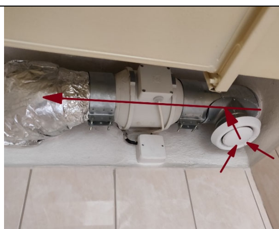
Obr. 1.21: Renovované odvodní potrubí s talířovým ventilem a ventilátorem v prostoru WC [autorská tvorba]
