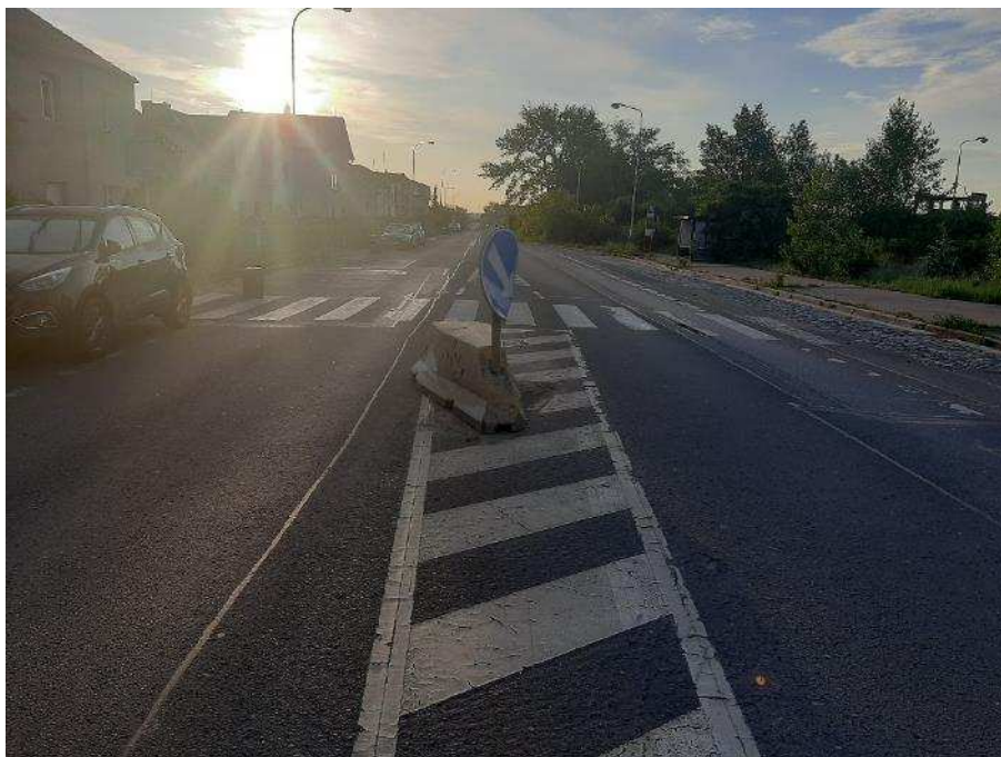
Obrázek 12 - Hlášená závada (posunutě svodidlo), zdroj: archiv autora
