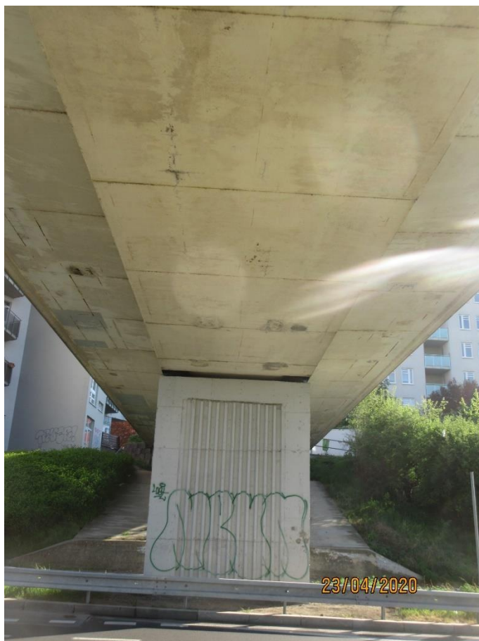
Obr. 010 Čelní pohled na Pilíř P03 od Pilíře P02, detail spodního líce NK: přechod lamely typu B na lamelu typu C a dále na lamelu typu A
