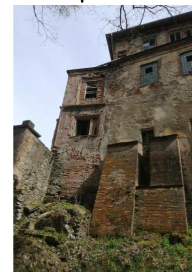
Obrázek 2 - Místní zámek S1 je rozsáhlý a z velké části velmi poškozený.
