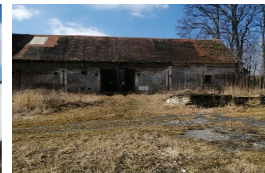
Obrázek 3 - Hospodářské budovy v těsné blízkosti zámku jsou ve velmi zanedbaném stavu.
