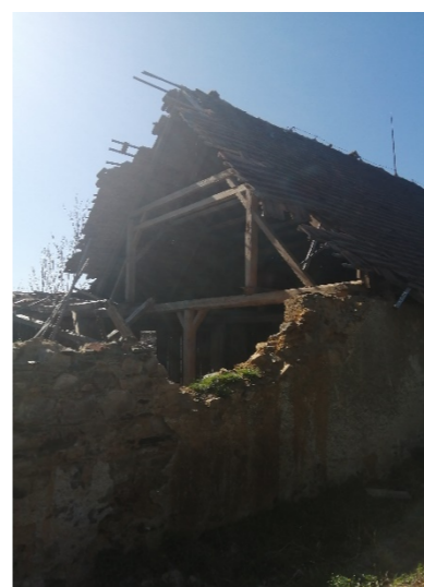
Obrázek 1 – Střecha a zdi stavení na dvoře jsou z větší části ve velmi špatném stavu.
