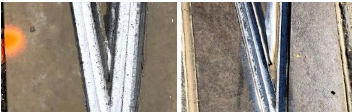
Obr.54-Rozjezdové hroty srdcovek Výtoň (v pravé části obrázku) a Spojovací č.2 (v levé části obrázku)
