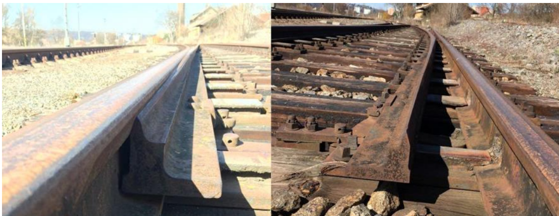
Obr.2-Pohled na úpravu jazyka v železniční výhybce
