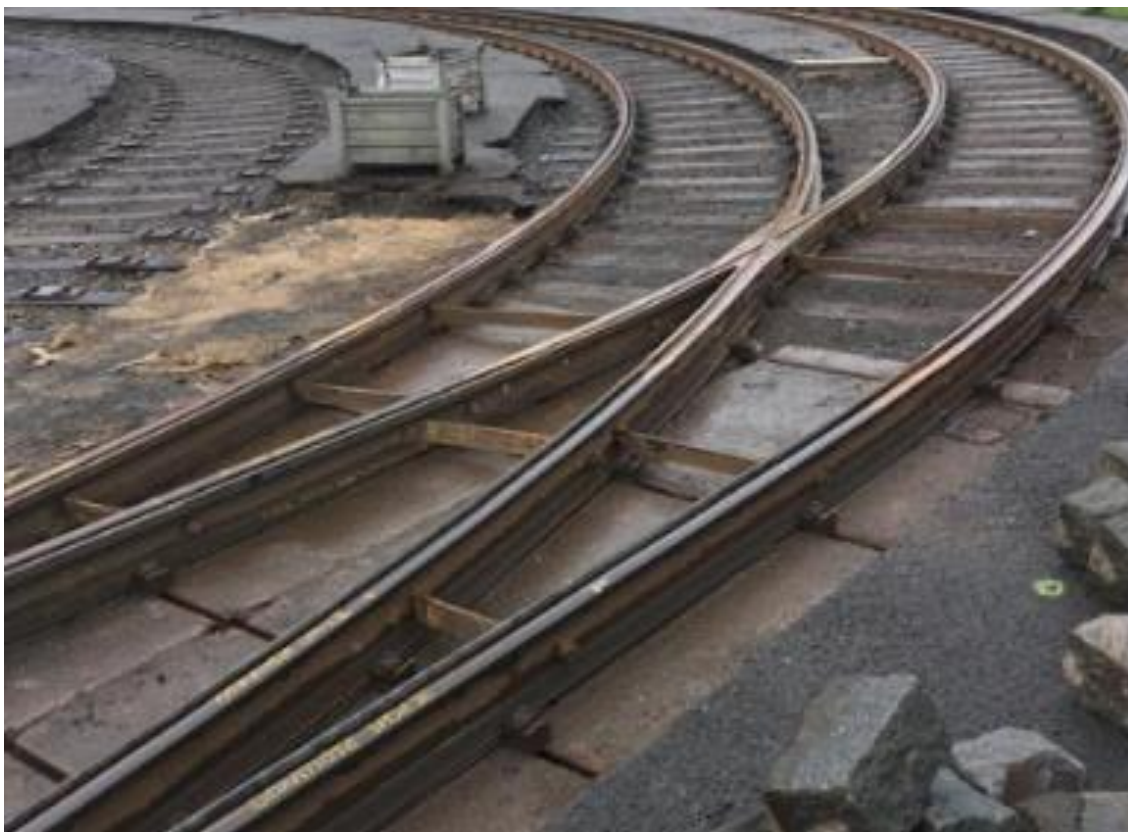
Obr.23-Upevnění na panelech VUIS a dřevěných pražcích druhé rozjezdové výhybky
