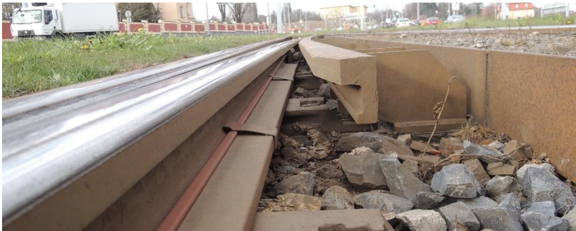
Obr.5-Pohled na přídržnici rychlostní tramvajové výhybky R01 v síti DPP (od zastávky Hradčanská směrem na Prašný most)
