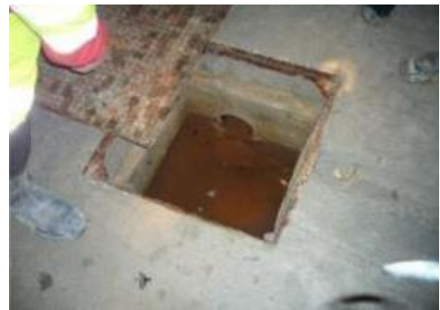
Obr. 22: Kontrolná šachta v úseku 1 730 - 1750 m, voda nepreteká z dôvodu porušenej drenáže deformáciou dna [21]
