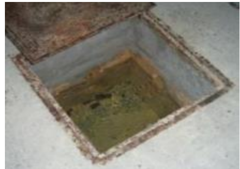
Obr. 24: Kontrolná šachta v úseku 2 400 - 2 450 m, stály odtok vody z posledných 250 m z masívu paleogénnych ílovcov [21]
