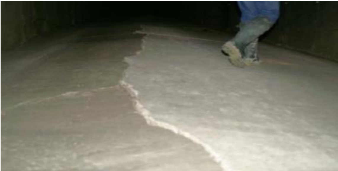
Obr. 21: Úsek 1 725 - 1 835 m – najviac porušený úsek dna štôlne s prasknutým a zdvihnutým betónom [21]
