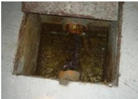
Obr. 21: Kontrolná šachta (staničenie 710 - 730 m), prietok drénovanej vody s Q do 2 \text{ l.s}^{-1} [21]
