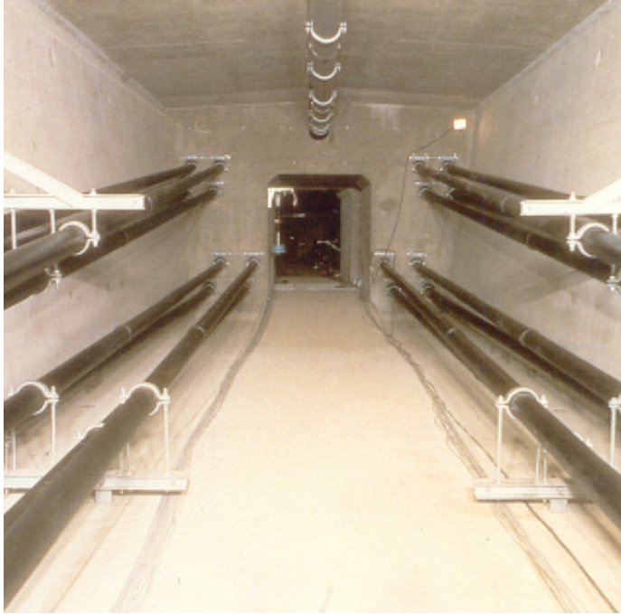
Obrázek 3.14: Volné kabely uvnitř komory [17].
