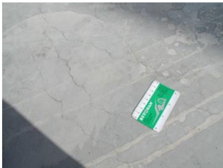
Obr. 3: Smršťovací trhliny způsobené nedostatečným ošetřováním betonu [17]
